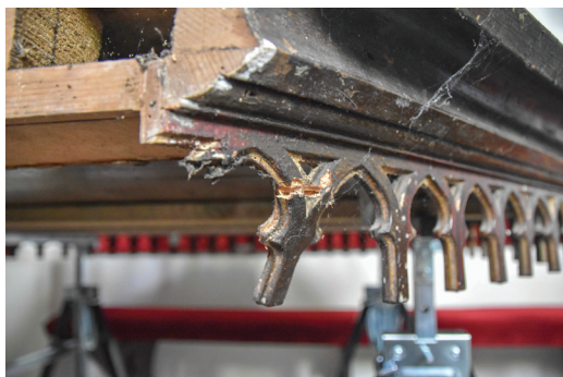
31. Ambona z kościoła pw. św. Wojciecha Biskupa i Męczennika w Uhowie – stan przed pracami konserwatorskimi – widok na uszkodzenia snycerki. Fot. M. Ponikowska-Preseisen Pulpit from the Church of St. Adalbert, Bishop and Martyr, in Uhowo – condition prior to conservation work – view of damage to the woodcarving. Photo by M. Ponikowska-Preseisen
