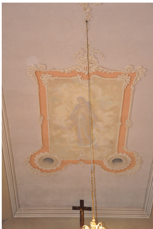
7. Juchnowiec. Malowidło na suficie w prezbiterium, stan przed konserwacją. Fot. Krzysztof Stawicki Juchnowiec. Ceiling painting in the presbytery, condition before conservation. Photo by Krzysztof Stawicki
