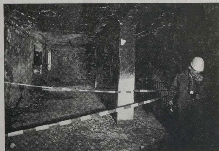
Policjant ogląda skutki pożaru w wypalonych wnętrzach
