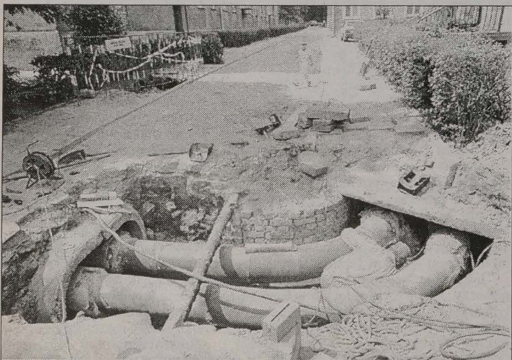
Od soboty wieczorem mieszkańcy 11 bloków z rejonu ulic Białówny i Zamenhofa pozbawieni byli ciepłej wody. Wczoraj ekipom z Zakładu Eksploatacji Sieci udało się usunąć tę awarię, której przyczyną było pęknięcie rury. (RR)
