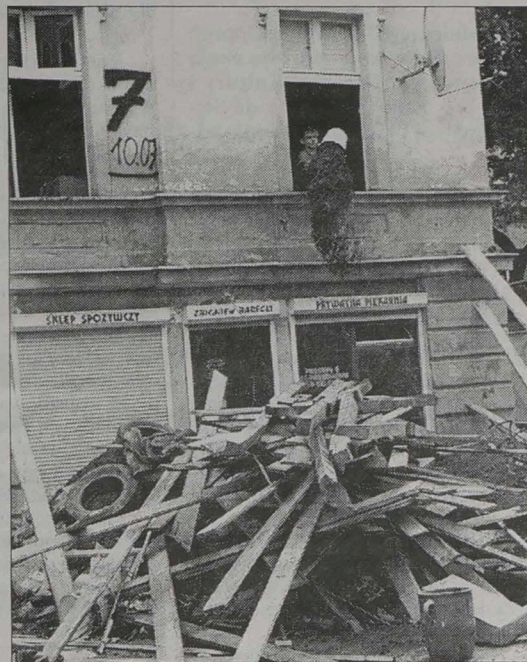
W Opolu jeszcze bardzo długo nie będzie można mówić o powrocie do normalnego życia. W zalanych dzielnicach rozpoczęła się kolejna faza walki ze skutkami powodzi: usuwanie z lokali, w których była woda podłóg, posadzek i tynków. Na zdjęciu: ul. Powstańców Śl. nr 7 na wyspie Pasieka. Piekarnia na parterze nie istnieje; znak na ścianie pokazuje dokąd 10 lipca sięgnęła woda.
