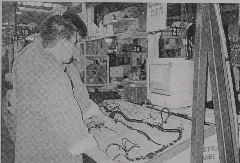
Stanowisko kontroli instalacji elektrycznej
