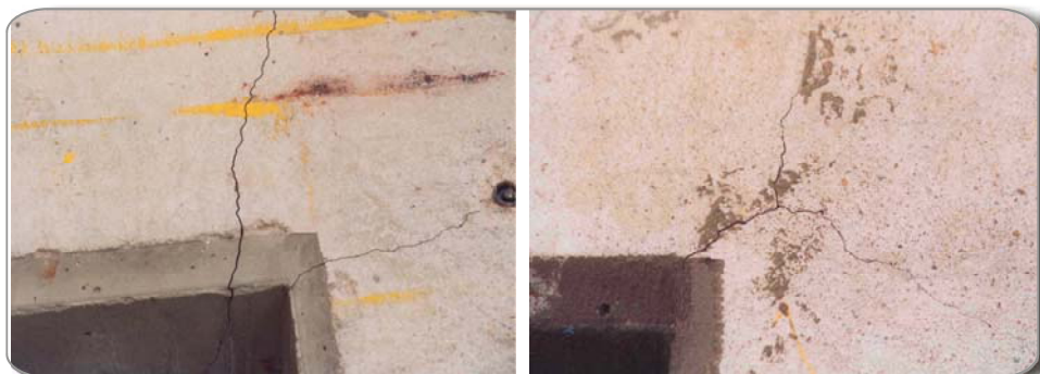
Rys. 8. Proces destrukcji naroży ścian powstałej wskutek działania obciążeń pozastatycznych przed próbą szczelności. Szerokość rozwarcia spękań zawiera się w przedziale 1,1÷3,2mm
