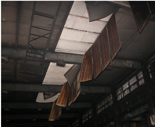
Rys. 3. Uszkodzenia wewnętrznej powierzchni płyt warstwowych.
