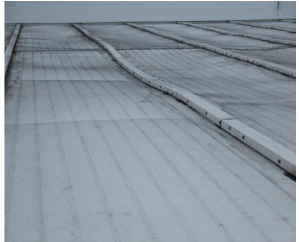
Rys. 4. Widok odkształconej połaci dachowej
