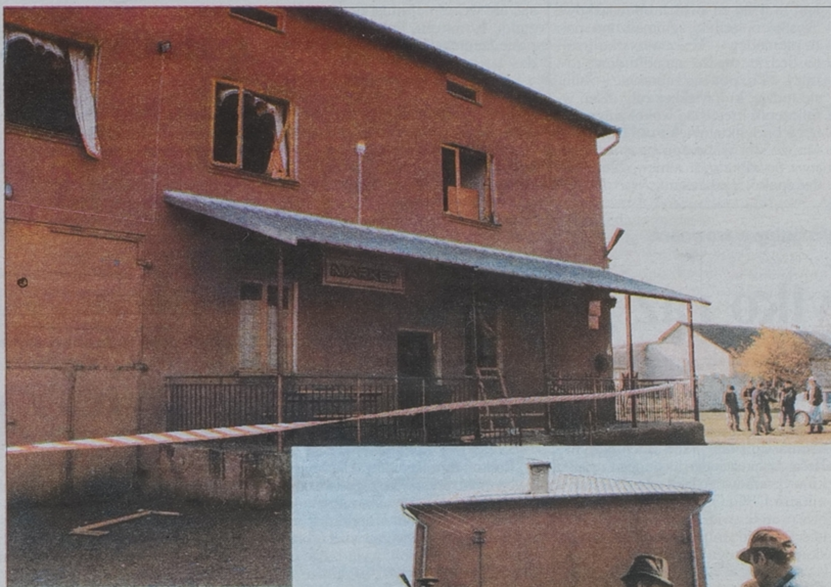
Od siły eksplozji wypadły wszystkie okna wraz z futrynami
