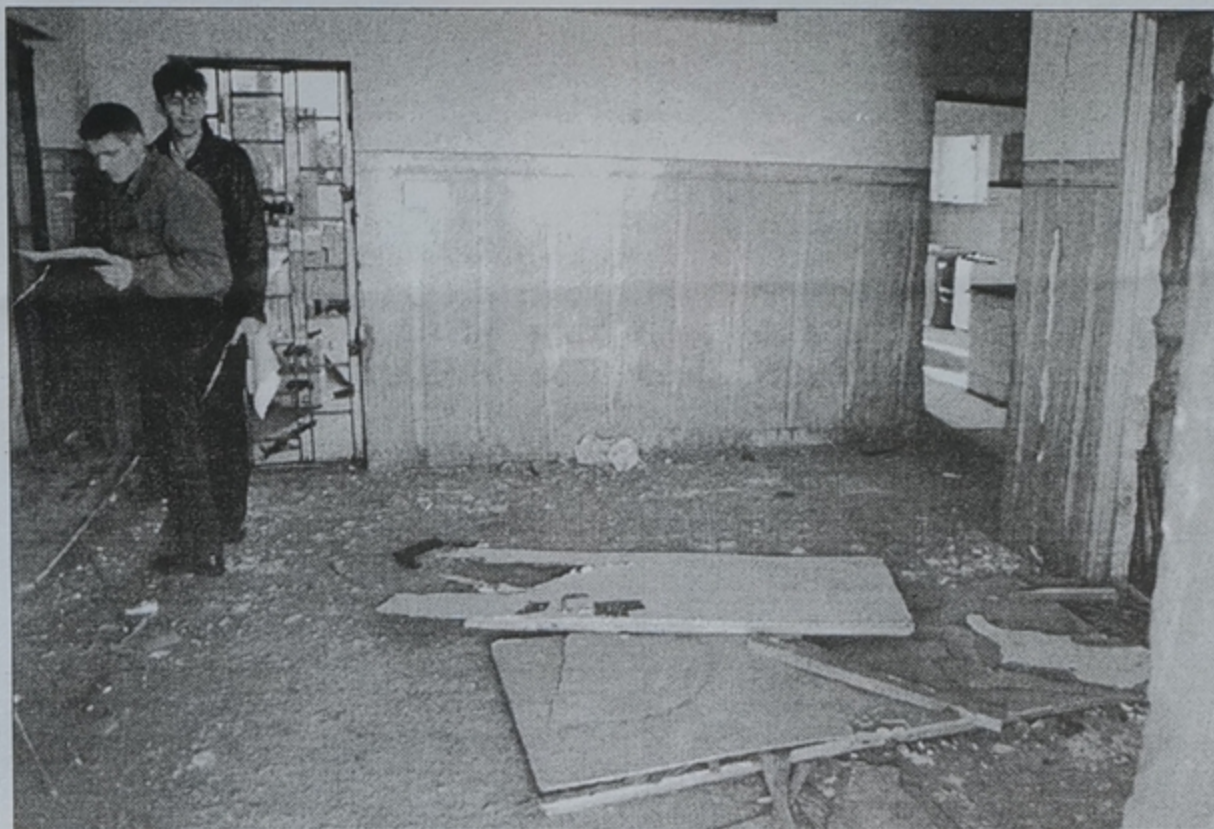
Zniszczenia w remizie są ogromne, m.in. od siły eksplozji wypadły okna i drzwi wraz z futrynami oraz uszkodzony został narożnik budynku
