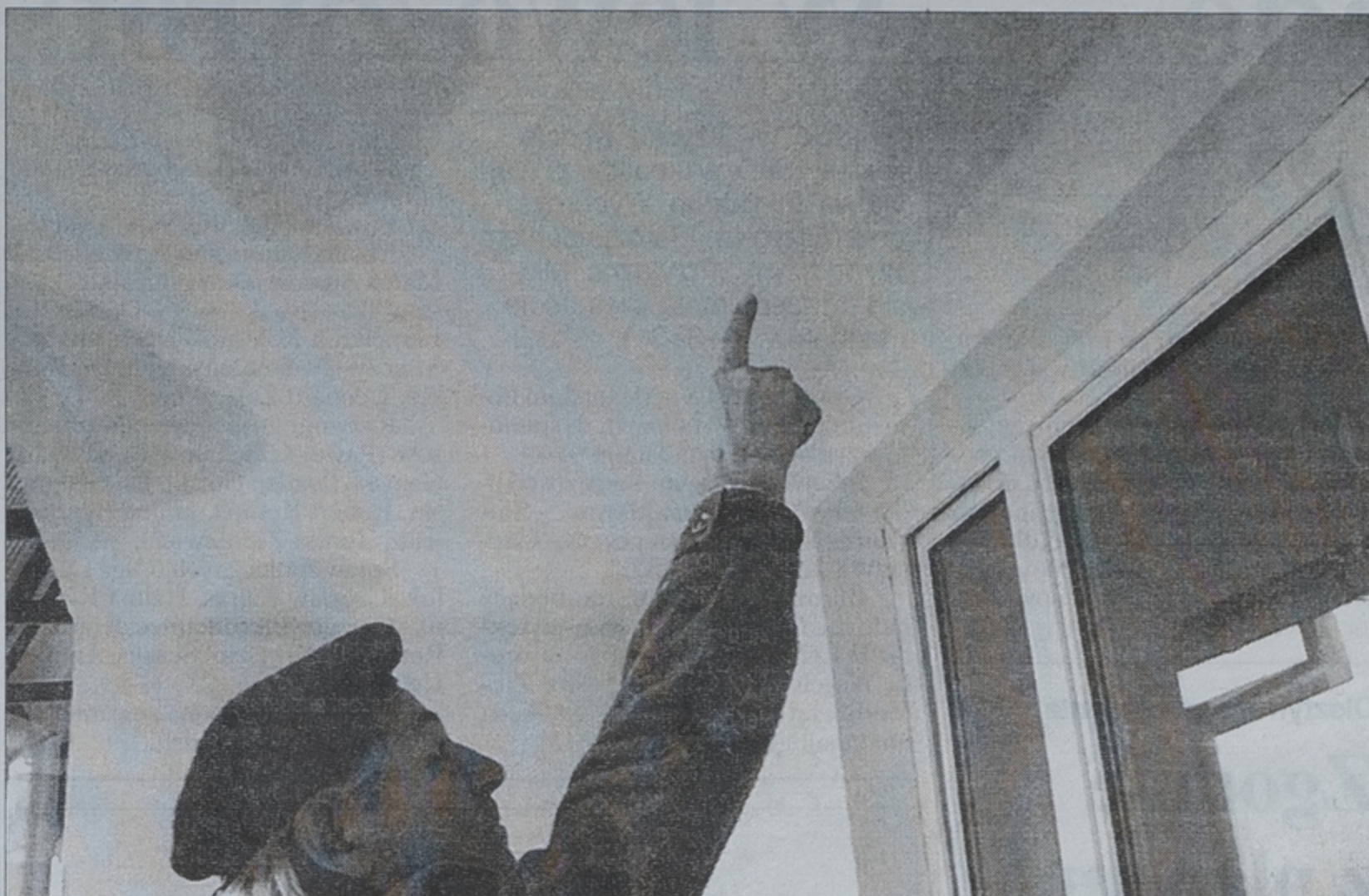
Antoni Taraszkiewicz pokazuje zacieki na balkonie
