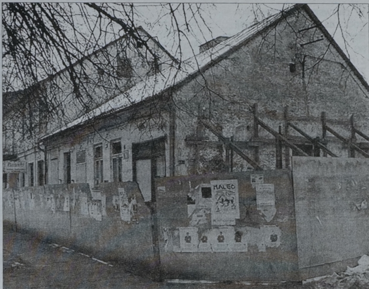
Ciekawe, jakie komorne należałoby zapłacić za lokum w takim budynku? Kamieniczki przy suwalskiej ulicy Kościuszki coraz bardziej upodabniają się do tej na zdjęciu.
