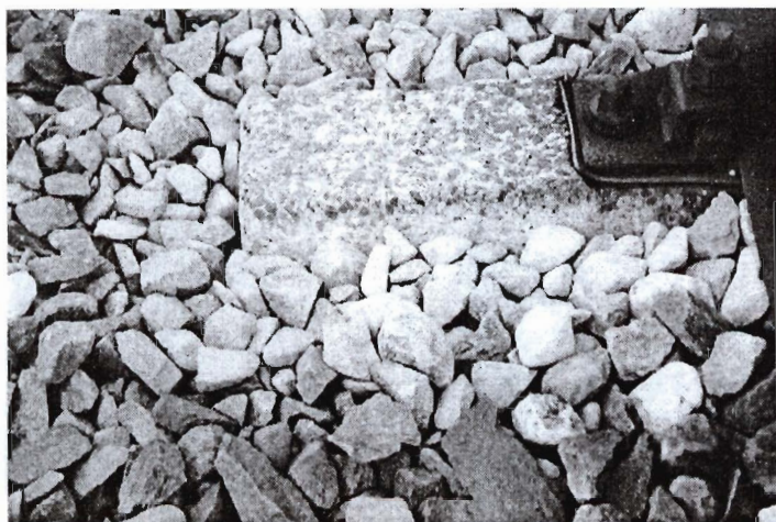
Rys. 1. Fragment końcowy zawieszonego podkładu w przypadku gdy strop tłucznia jest poniżej górnej krawędzi podkładów. Oszlifowane boczne powierzchnie podkładów oraz ziarna tłucznia do nich przyległe są koloru jasnego
