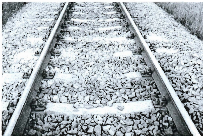
Rys. 4. Identyfikacja nieprawidłowego oparcia sąsiednich podkładów sprężonych na podsypce, na podstawie jasnego koloru ziaren tłucznia
