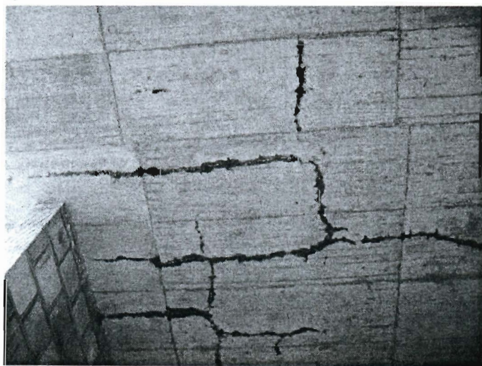
Rys. 6. Widok od spodu płyty stropowej – przez rysy przesącza się woda opadowa
