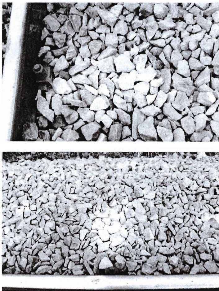
Rys. 3. Przykłady fragmentu torowiska z wysokim poziomem tłucznia (strop tłucznia znajduje się powyżej górnej powierzchni podkładów sprężonych). Usytuowanie podkładów można zidentyfikować na podstawie widocznych elementów mocowania szyn. Tłuczeń nad zawieszonymi fragmentami podkładów ma kolor jasny na skutek szlifowania powstającego podczas ruchu pociągów
