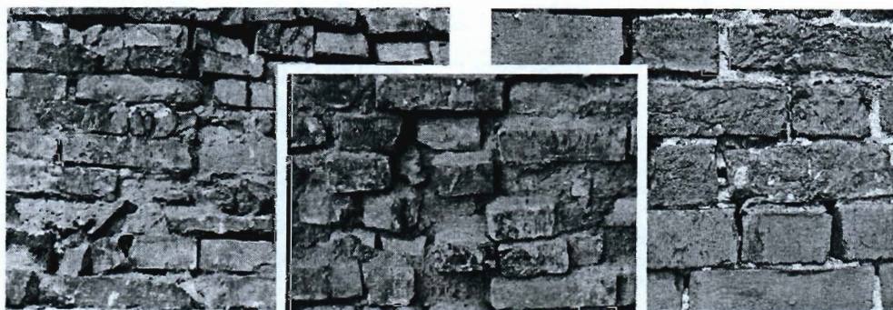
Rys. 9. Stadia degradacji zaprawy w spoinach murów ceglanych
