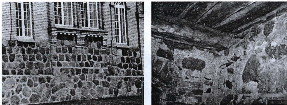
Rys. 6. Efekty procesów karbonizacji zapraw w strefach ścian kondygnacji podziemnych oraz w murach fundamentowych z kamienia polnego
