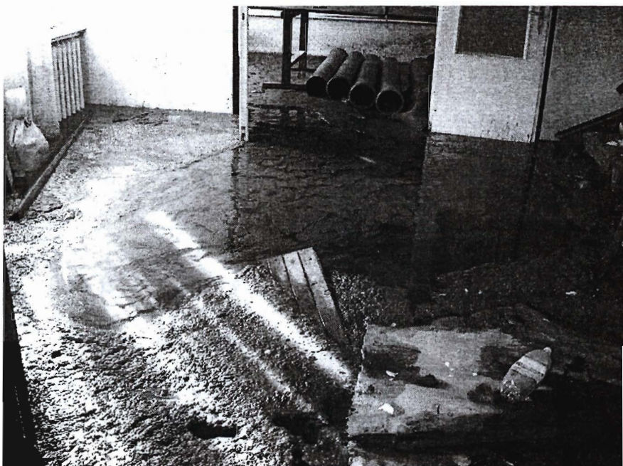
Rys. 6. Sufozja podłoża spod posadzki budynku gospodarczego
