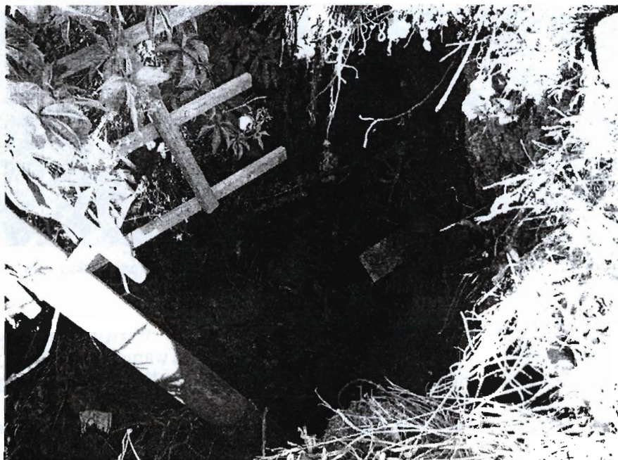
Rys. 4. Zapadlisko o głębokości ok. 3m za budynkiem gospodarczym; w dnie widoczne są intensywne sączenia
