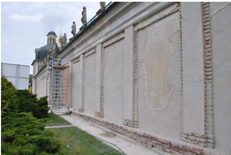
Rys. 4. Widok fragmentu muru w Sanktuarium Maryjnym w Świętej Lipce, podczas wykonywania prac renowacyjnych z zastosowaniem zapraw bezcementowych Mapei-Antique – zdjęcia z archiwum MAPEI Polska Sp. z o. o.
