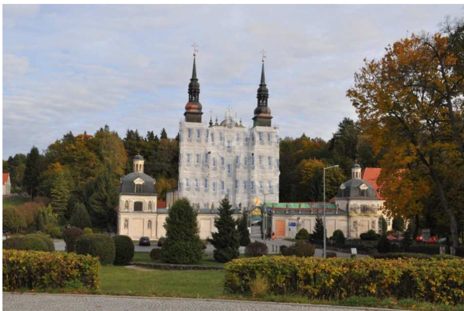
Rys. 5. Widok Sanktuarium Maryjnego w Świętej Lipce podczas prowadzonych prac renowacyjnych (2010-2011) – zdjęcia z archiwum MAPEI Polska Sp. z o. o.
