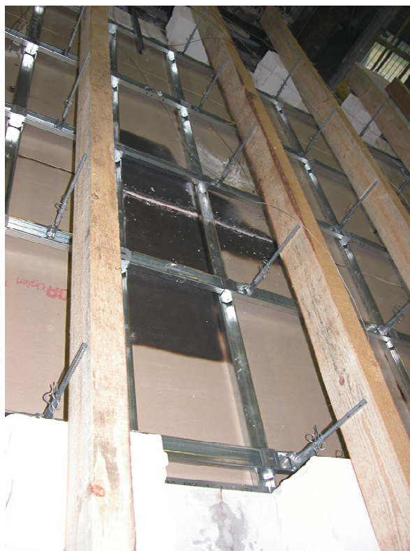
Rys. 3. Widok fragmentu sufitu podwieszonoego od strony nienagrzewanej po badaniu
