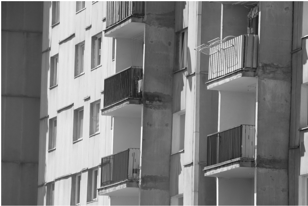
Rys. 2. Widok fragmentu budynku wielkopłytkowego i loggi dostawianych, przecieki na złączach, brak obróbek. Stan techniczny dostateczny
