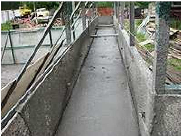
Rys. 8. Ściana wykonana w technologii „CastWall” – w środku płyt Eco-Board nieautoklawizowany gazobeton (www.castwall.com)
