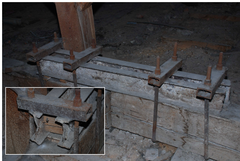
Rys. 5. Wady stalowej konstrukcji wzmacniającej połączenie belek drewnianych
