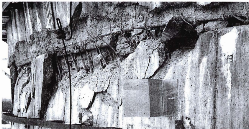
Rys. 11. Stan degradacji wieńca w strefie połączenia powłok: stożkowej i walcowej
