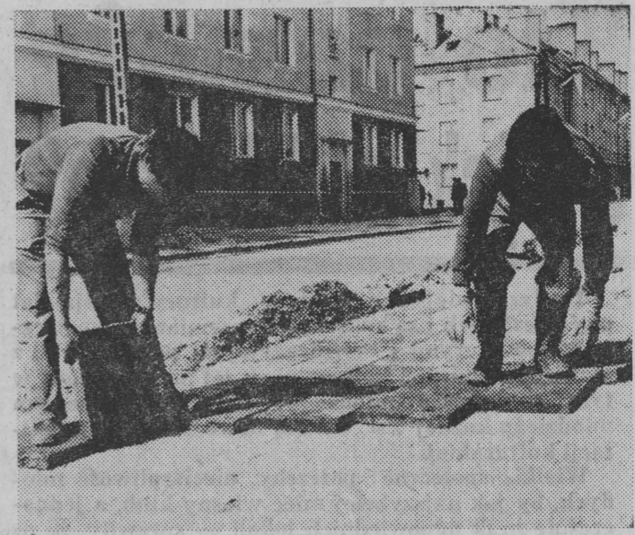
Prace kosmetyczne w Zambrowie. Najpierw w czynie społecznym rozebrano zniszczone chodniki i sprzątnięto stare płytki, a teraz układa się nowe.
