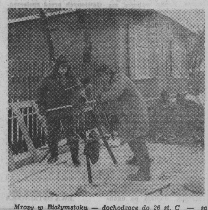
Mrozy w Białymstoku — dochodzące do 26 st. C — są przyczyną licznych awarii instalacji wodociagowych i kanalizacyjnych. Najczęściej pękają szwy rur oraz kolanka. 20-osobowa brigada z Wojewódzkiego Przedsiębiorstwa Wodociągów i Kanalizacji dziennie załatwia około 35 zgłoszeń z prośbą o usunięcie awarii.
