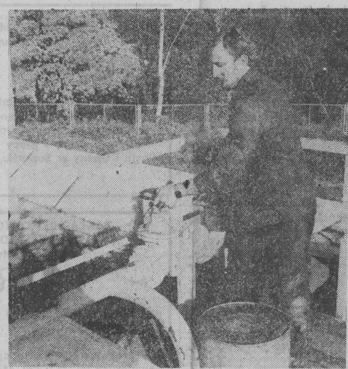
Nad pracą zakładową oczyszczalni ścieków czuwa hydraulik Ryszard Kordowski. Wspomnianą oczyszczalnię typu bioblok uruchomiono w kwietniu br.
