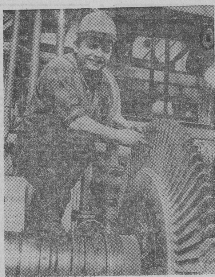
Brygadziście Zakładu Remontowego Energetyki w Warszawie — Jerzy Sarosiek: „Dla mnie turbina nie ma tajemnic”.
