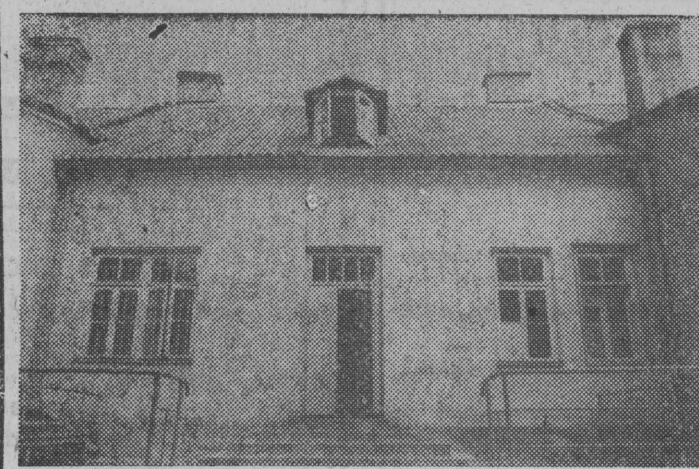
Stara „wytężniak” mocno się już syje i kto wie, czy fachowcy od budowlanych „wyroków” nie zabiorą tu w ogóle umieszczać ludzi?
