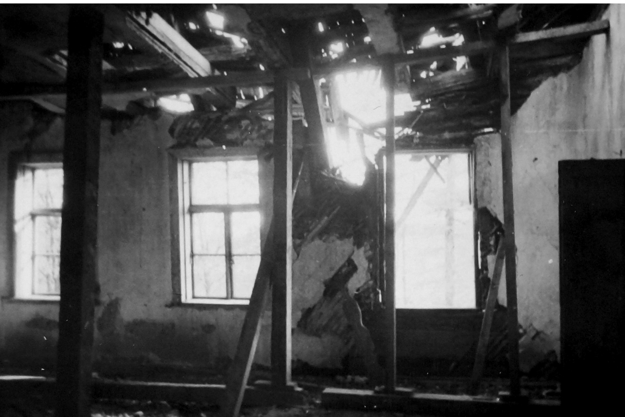
Fotografia 266. Widok na zniszczone wnętrza dworskie. Autor zdjęcia: Władysław Paszkowski. Data wykonania: 1959. Oryginał w: WUOZwB
