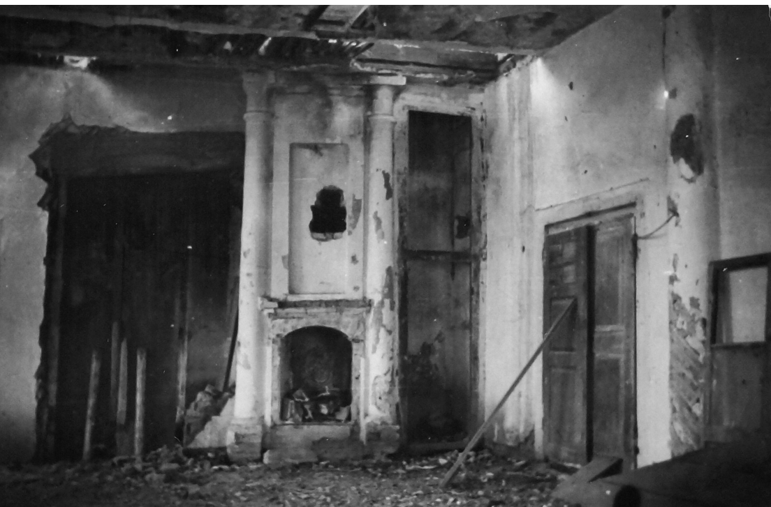
Fotografia 264. Widok na zniszczony kominek w dworskim salonie. Autor zdjęcia: Władysław Paszkowski. Data wykonania: 1959. Oryginał w: WUOZwB
