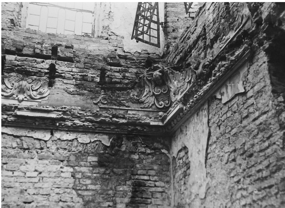
Fotografia 52. Obraz zniszczeń wewnątrz pałacowych. Autor zdjęcia: Władysław Paszkowski. Data wykonania: 1946. Oryginał w: WUOZwB
