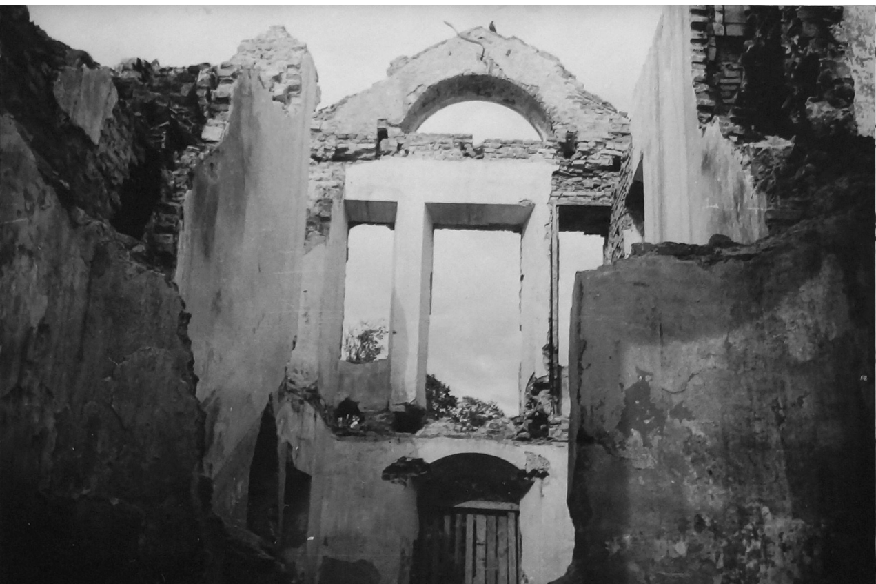
Fotografia 270. Obraz zniszczeń wewnątrz pałacowych. Autor zdjęcia: Władysław Paszkowski. Data wykonania: 1947. Oryginał w: WUOZwB
