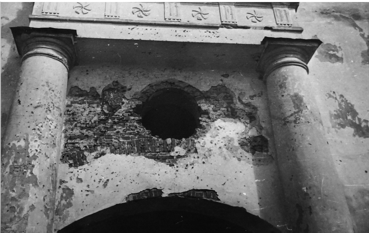
Fotografia 218. Widok w zbliżeniu ukazujący zniszczony pozorny portyk z dwiema półkolumnami toskańskimi. Autor zdjęcia: Władysław Paszkowski. Data wykonania: 1956. Oryginał w: WUOZwB
