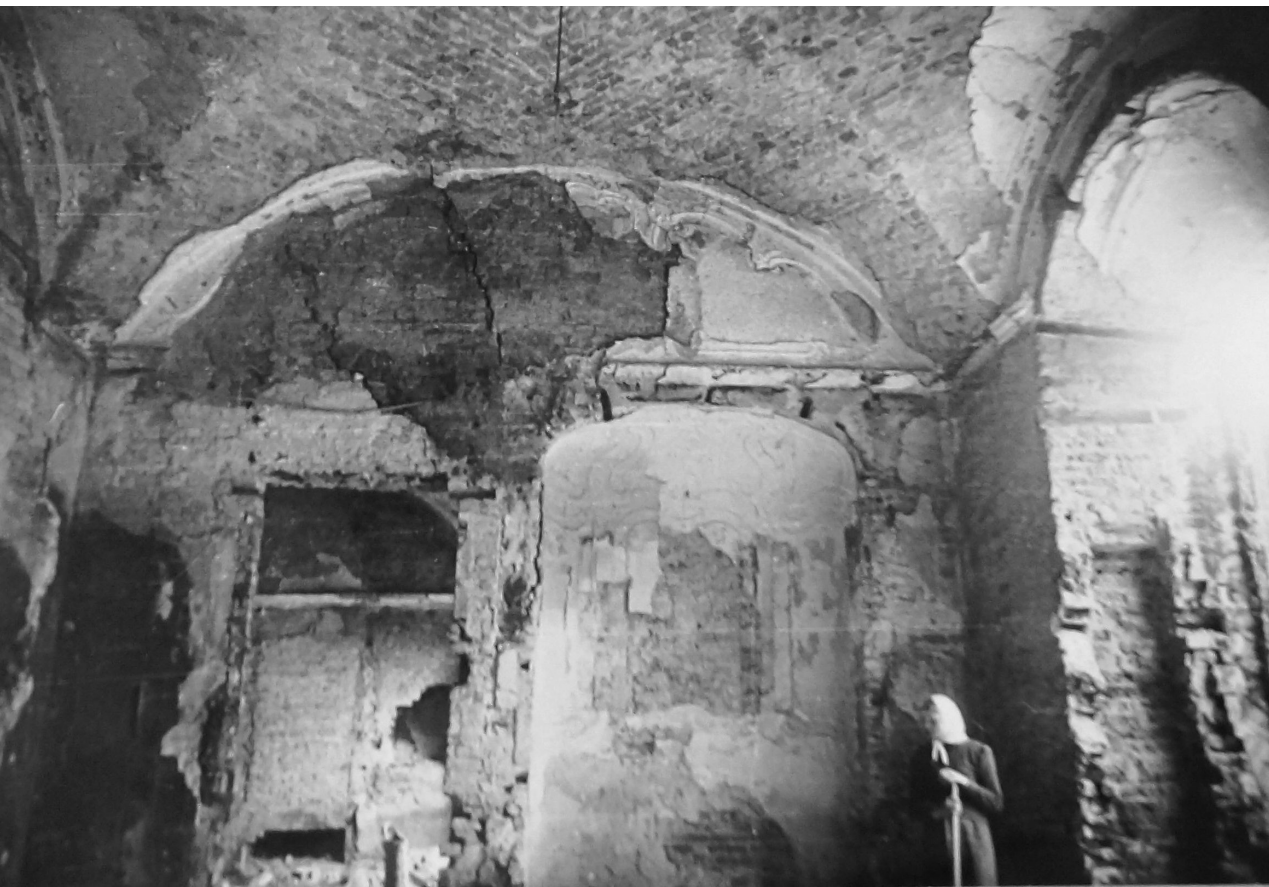
Fotografia 49. Obraz zniszczeń wewnątrz pałacowych. Autor zdjęcia: Władysław Paszkowski. Data wykonania: 1947. Oryginał w: WUOZwB
