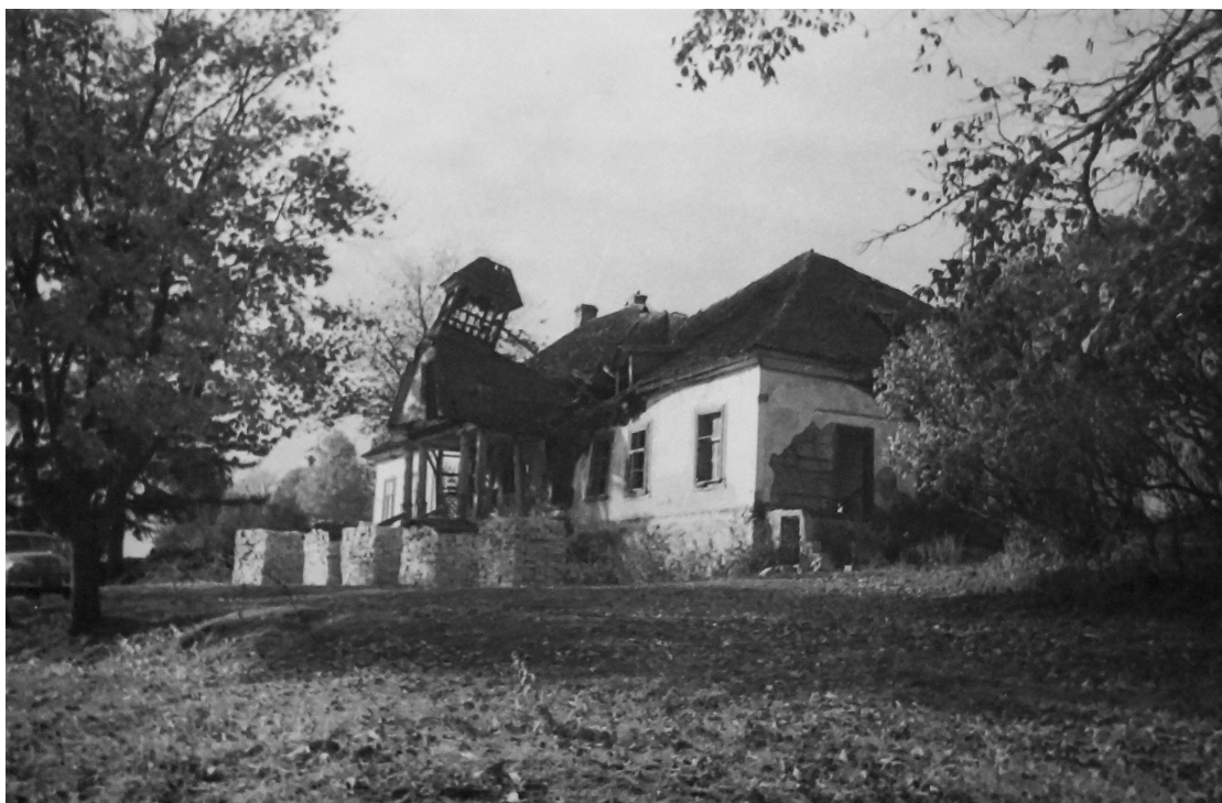
Fotografia 261. Obraz postępujących zniszczeń fasady frontowej i elewacji północnej dworku. Autor zdjęcia: Władysław Paszkowski.
