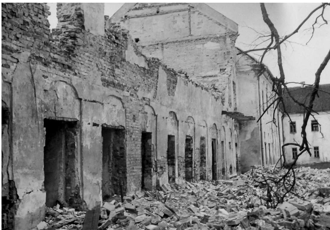
Fotografia 190. Obraz zniszczeń obiektów klasztornych. Autor zdjęcia: Władysław Paszkowski. Data wykonania: 1947. Oryginał w: WUOZwB
