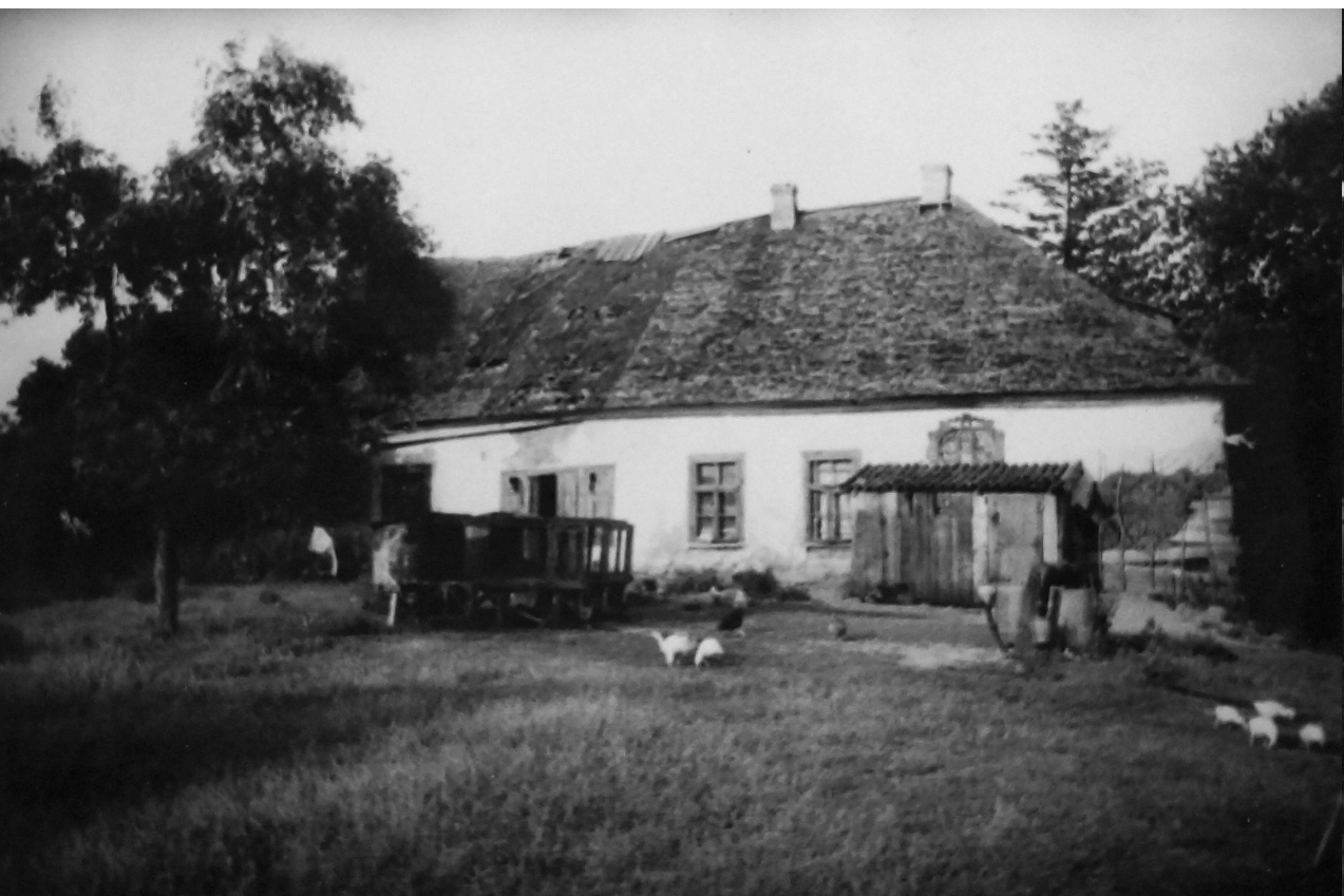
Fotografia 262. Obraz zniszczeń fasady ogrodowej (zachodniej) dworku. Autor zdjęcia: Władysław Paszkowski. Data wykonania: 1957. Oryginał w: WUOZwB
