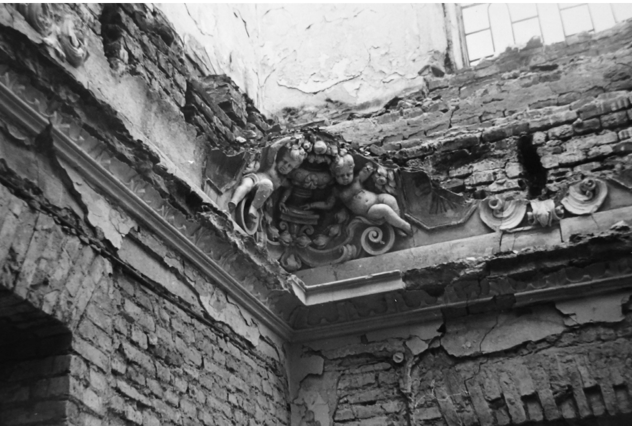
Fotografia 53. Obraz zniszczeń wewnątrz pałacowych. Autor zdjęcia: Władysław Paszkowski. Data wykonania: 1946. Oryginał w: WUOZwB
