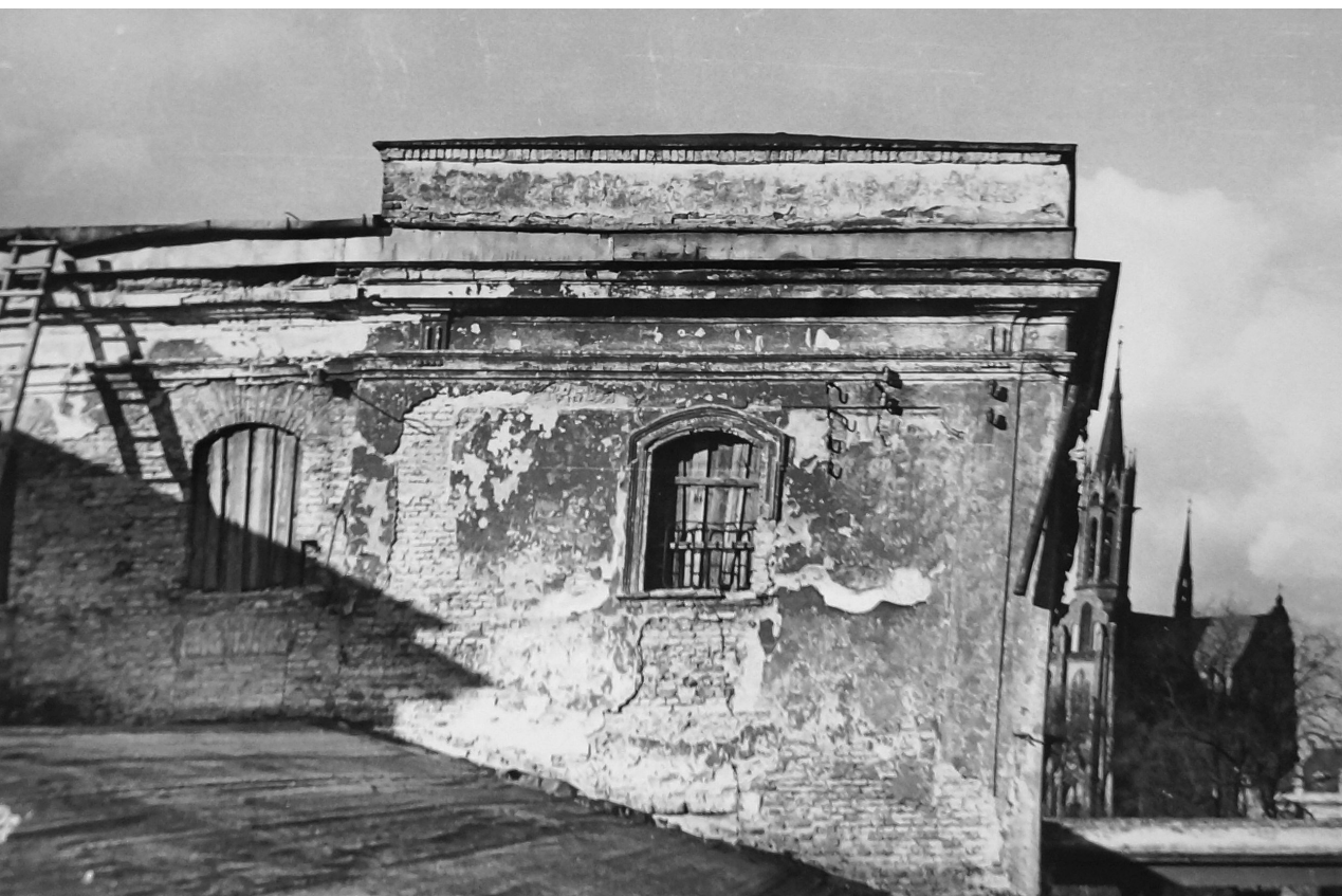
Fotografia 41. Obraz zniszczeń prawej (północnej) oficyny pałacowej. Autor zdjęcia: Władysław Paszkowski. Data wykonania: 1946. Oryginał w: WUOZwB
