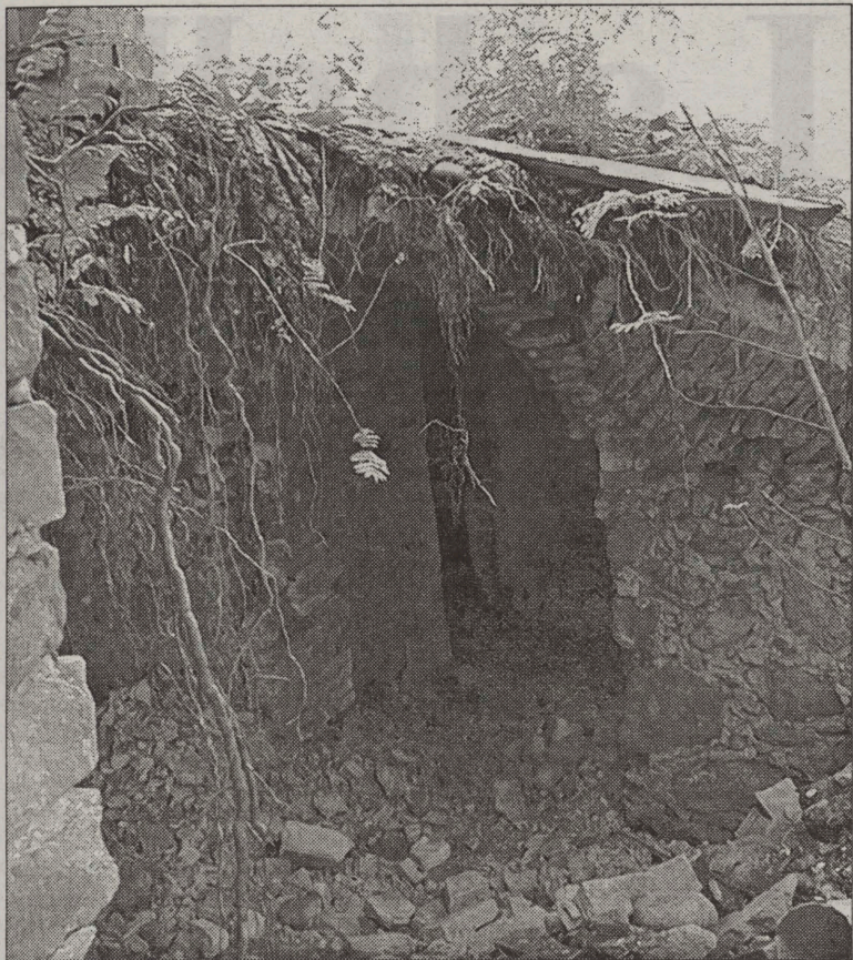
Zniszczone piwnice dawnych dóbr de Virionów zaskakują swoim ogromem
