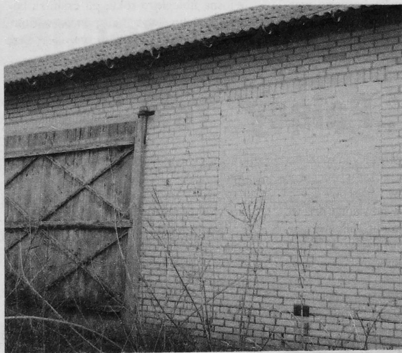
Stodoła z zamurowanym oknem (ślady widoczne do dzisiaj)
