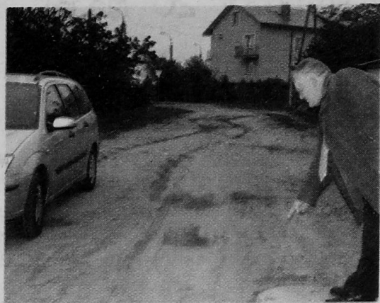
Pokrywa tej studzienki leży na zniszczonym „kołnierzu” i w każdej chwili może się zapaść
