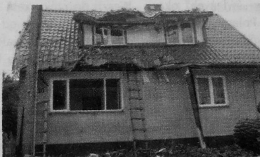
Dach na tym domu w Raciborach zniszczyła padająca topola
