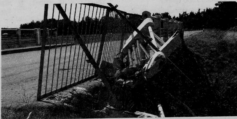
Wskutek wypadku drogowego na mostku koło Turośli uszkodzona została bariera. „Zabezpieczono” ją... ustawieniem metalowej siatki. I tak zostało.
