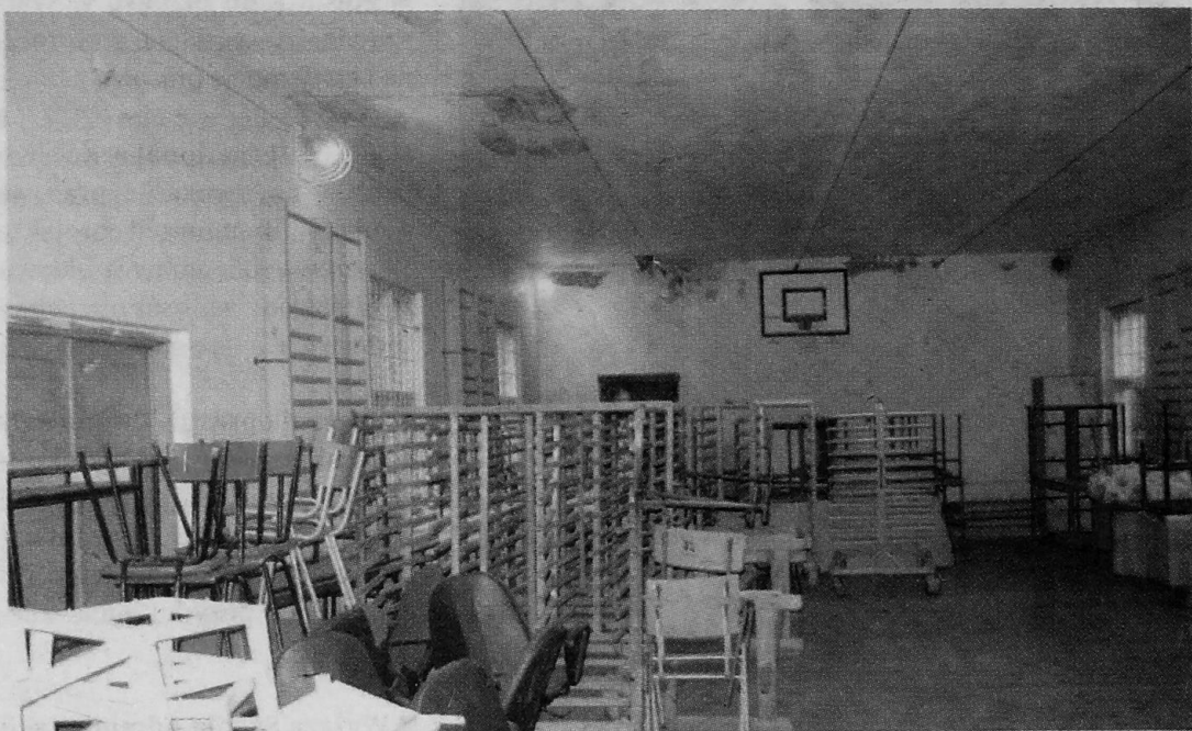
Sala zwana „cyrkiem”, w której sufit grozi zawaleniem, miała być salą gimnastyczną
