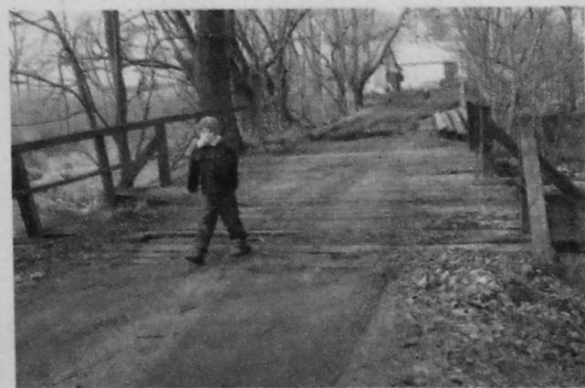
Zniszczony pokład i połamane poręcze
