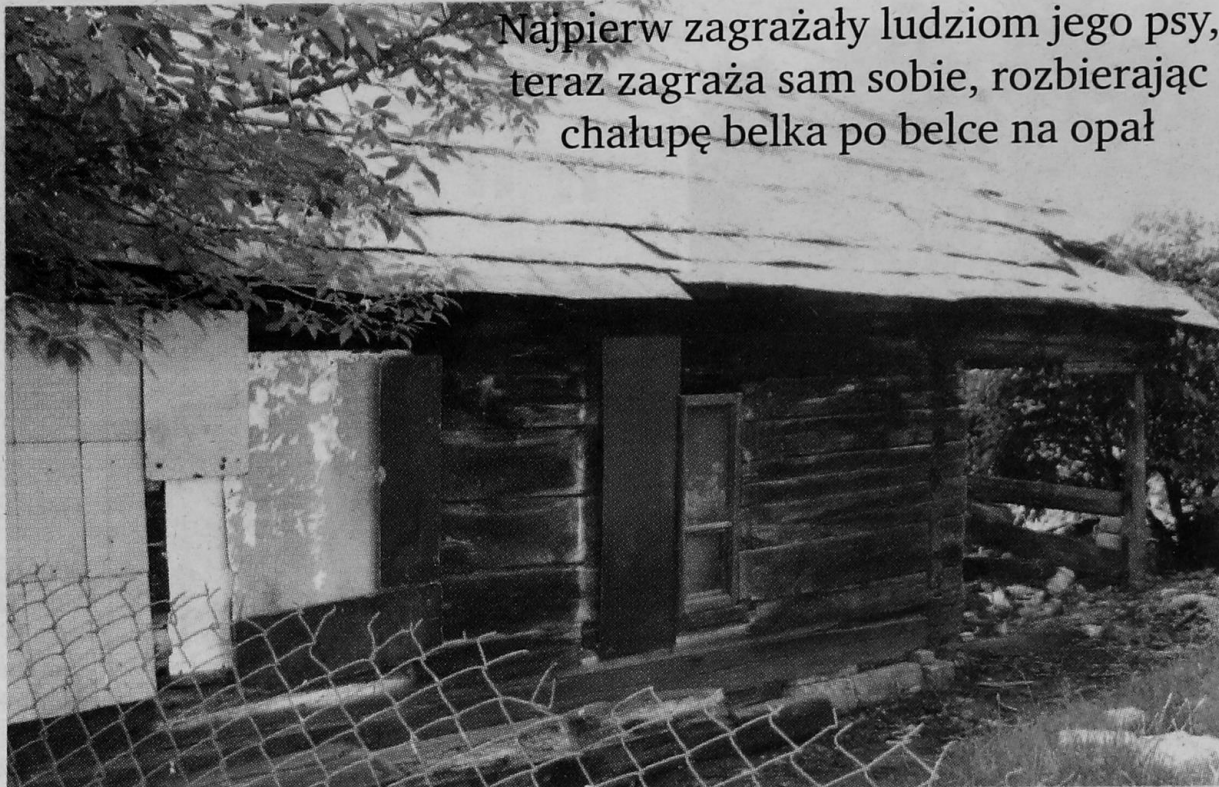
Okna zabite dyktą, rozebrana szczytowa ściana od podwórza, dach na prowizorycznych podporach
