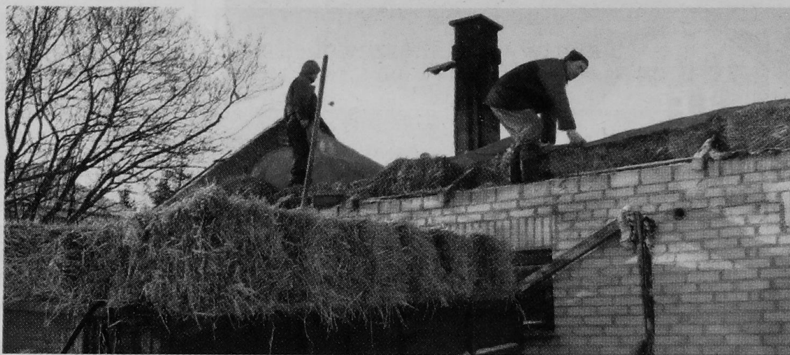
Słomą od Wojciecha Walczuka sąsiedzi zabezpieczają pozbawione dachu mury
