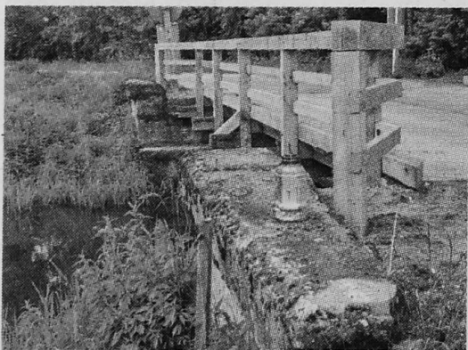
W tym miejscu auto uderzyło w przyczółek i wpadło do wody
