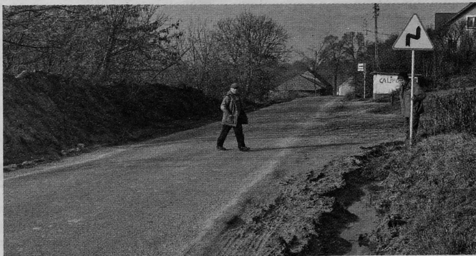
Widoczna z lewej strony jezdni góra ziemi, hamująca spływ wód opadowych z drogi, to dzieło właściciela posesji, a nie drogowców, zapewnia zarządca
