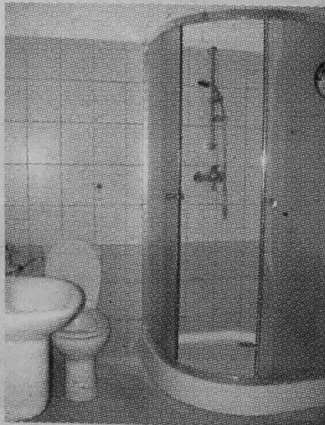
Łazienka w budynku socjalnym
