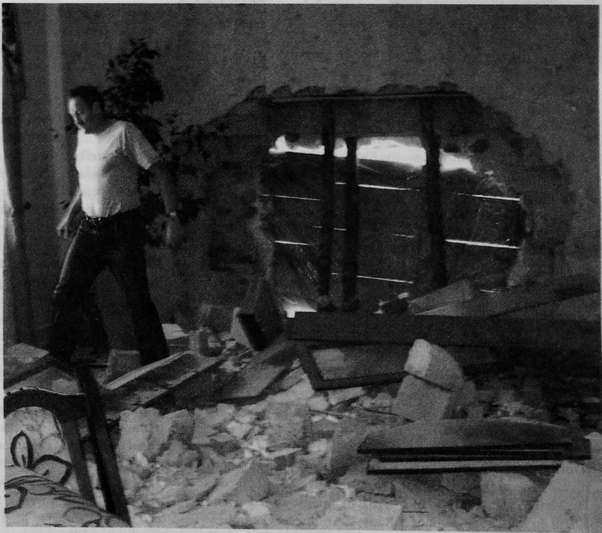
Zrujnowane mieszkanie Bajaków; dziurę w murze, wybitą przez samochód, prowizorycznie zastłonili deskami
