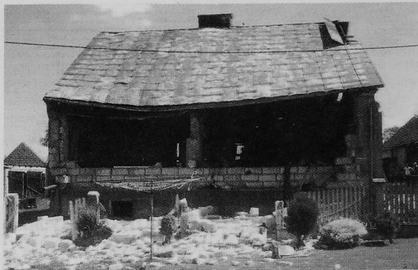
Zniszczony wybuchem gazu dom pod Kolnem; gospodarz z poparzeniami leży w szpitalu
