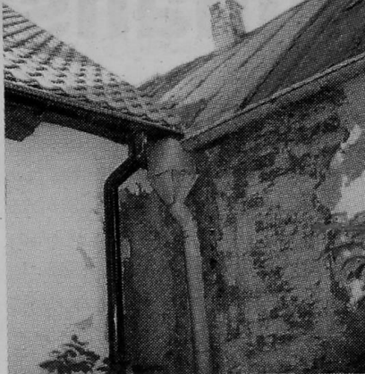
Cała ściana szczytowa zabytkowego dworku jest mokra, a drewniana powala zbutwiała
