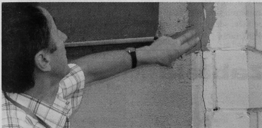
Józef Czajkowski pokazuje pęknięcie między ścianą z płyty a dociepleniem sprzed 20 lat
