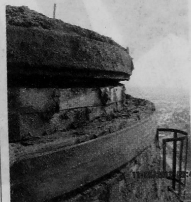
Fatalny stan kotłowni w Łomży
