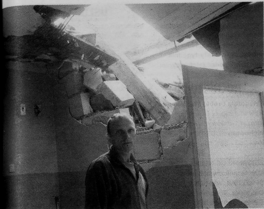
Tomasz Narewski: – Tutaj stała matka, gdy strop się zawalił
