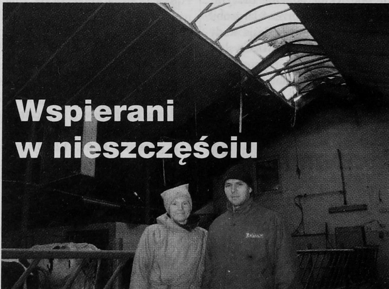
Kamil Kosiński z żoną Sylwią; za nimi zniszczona pożarem część nowej obory z wypaloną dziurą w dachu
