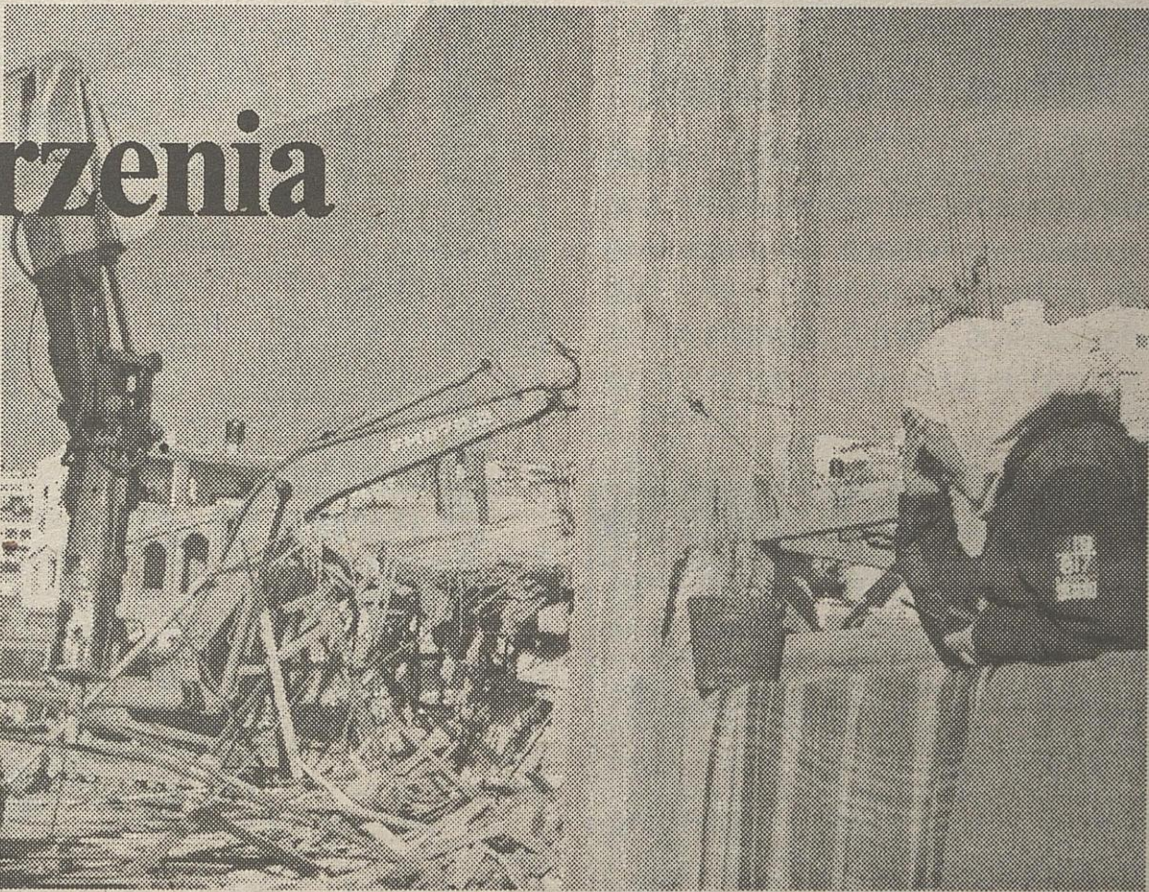
Burzenie nowego domu palestyńskiego w Issawiyah we wschodniej Jerozolimie. Z prawej rozpaczająca kobieta z tego domu.
