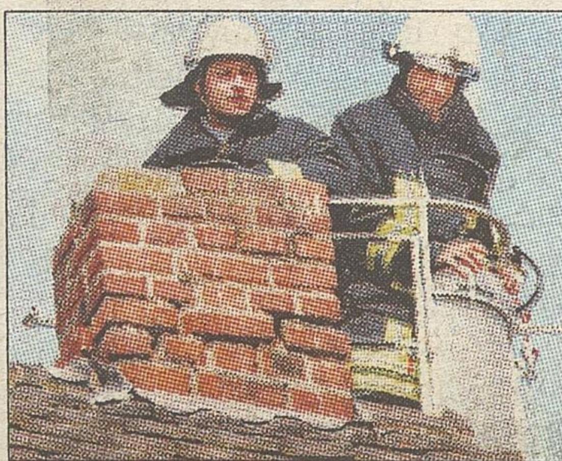
Dwaj strażacy sprawdzają w Linnich (zach. Niemcy) komin uszkodzony w czasie trzęsienia ziemi o sile 4,7 w skali Richtera, jakie w poniedziałek rano nawiedziło okolice Akwizgranu
