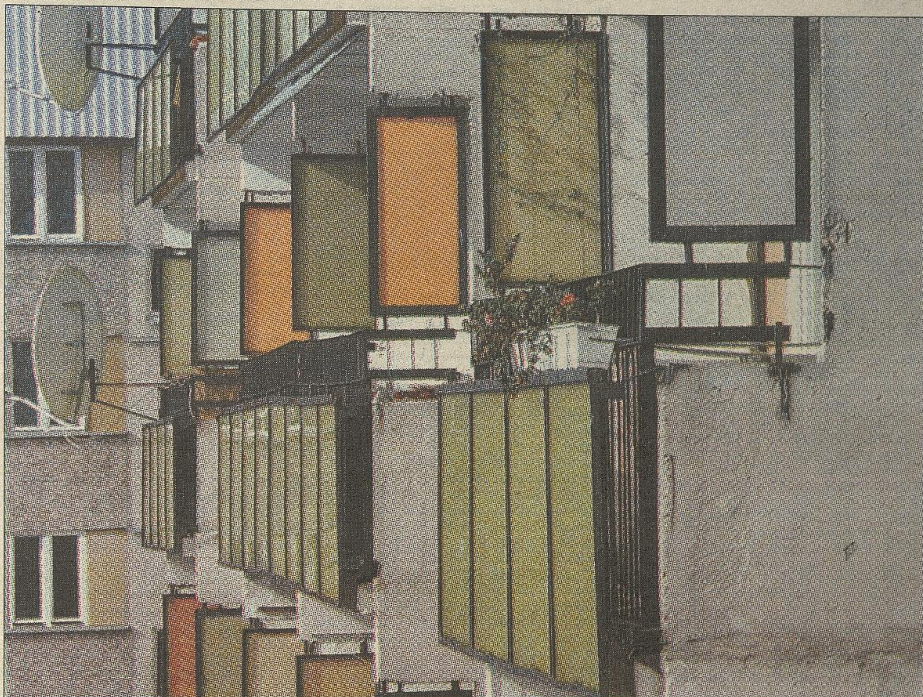
Metalowe elementy balkonów szczególnie narażone są na korozję
