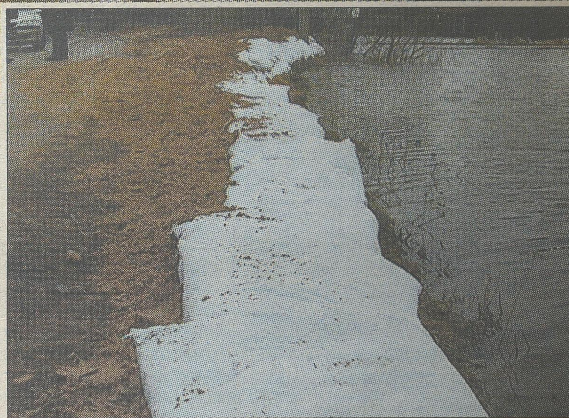
Woda przerwała w dwóch miejscach drogę dojazdową do oczyszczalni ścieków w Brańsku. Konieczne okazało się wzmocnienie nasypu workami z piaskiem.
