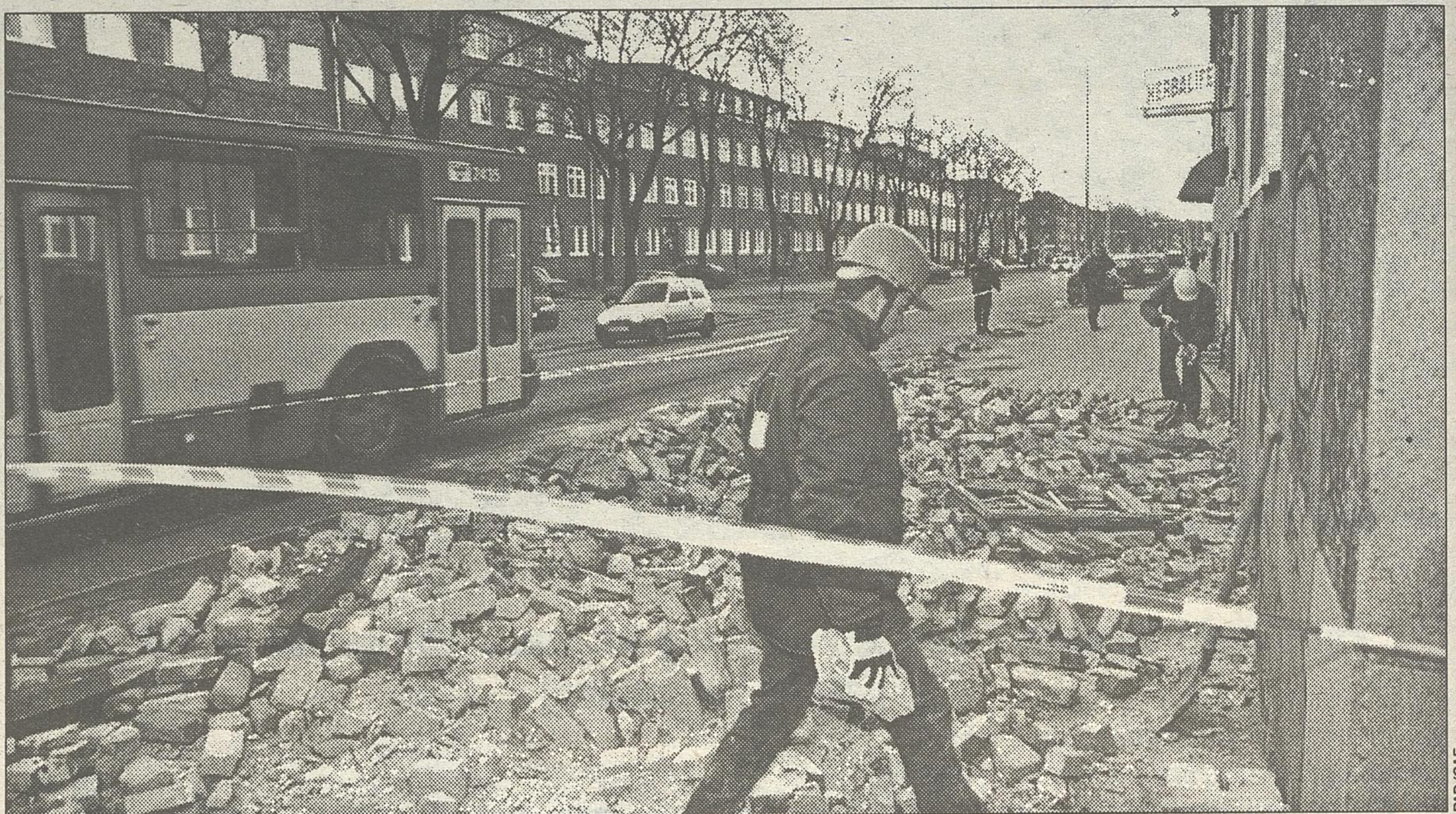
Szalejące nad Polską wichury wyrządziły wiele szkód w całym kraju. W Gdańsku-Wrzeszczu przy ul. Kościuszki zawałała się duża część ściany szczytowej kamienicy. Kawały muru spadły na chodnik i jezdnię. Na szczęście nikt nie doznał obrażeń.
