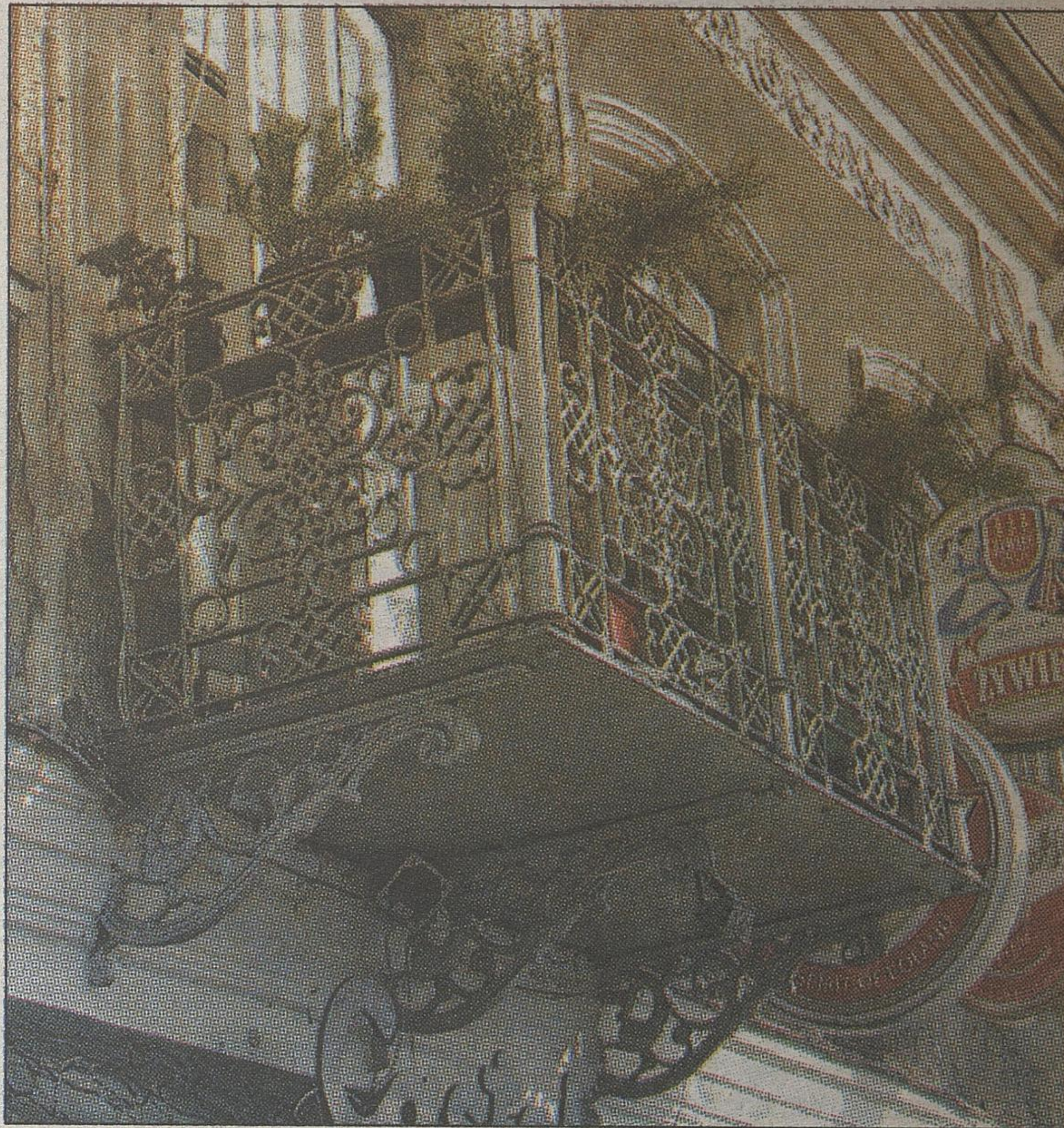
Najbardziej wyeksponowaną częścią balkonu jest balustrada, natomiast najbardziej eksploatowaną – jego posadzka
