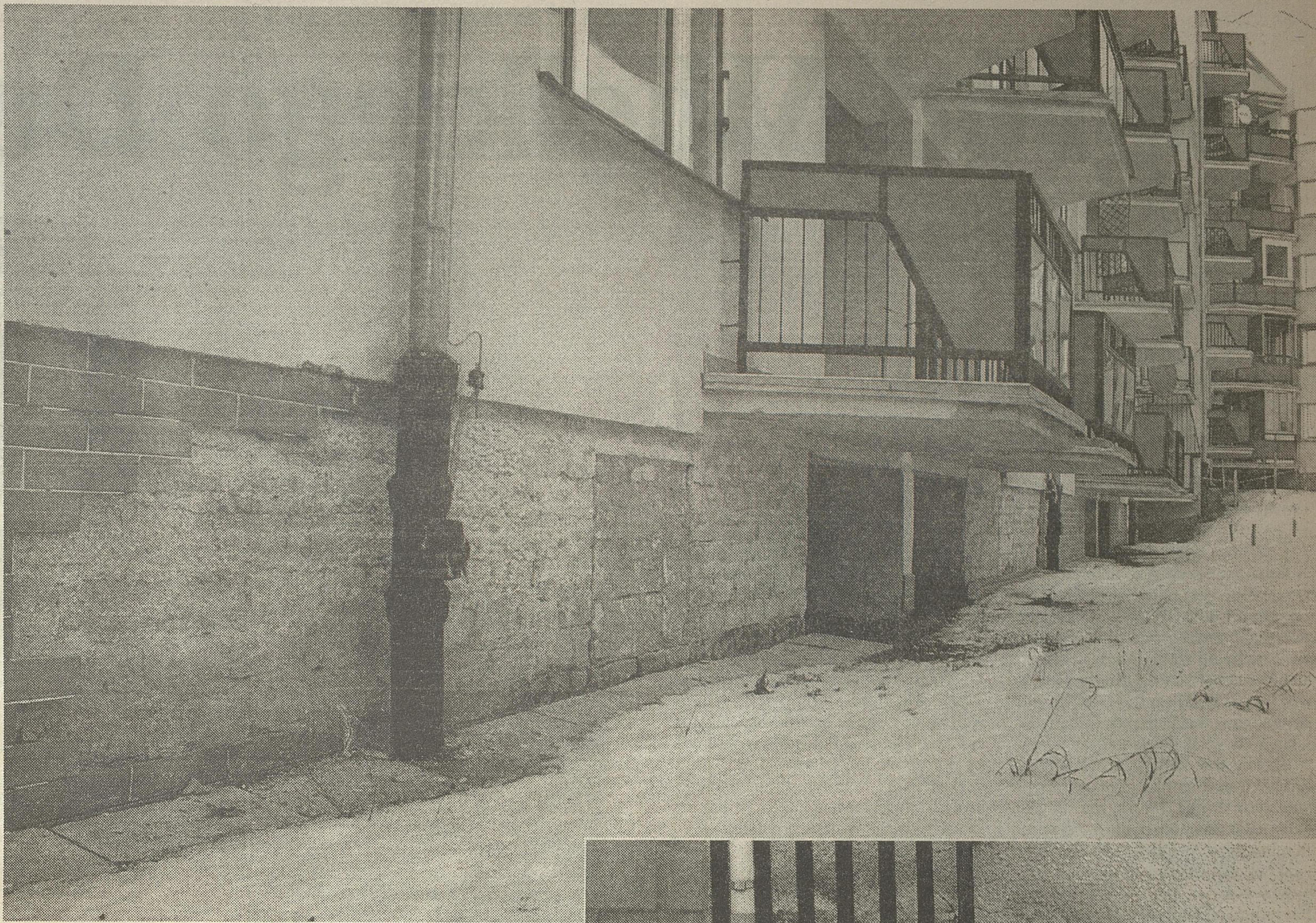
Bloki wybudowane w latach 90. już dziś nadają się do remontu
